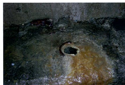
写真-1 基礎排水孔
