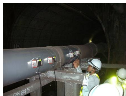
写真 1 超音波流量計設置状況
