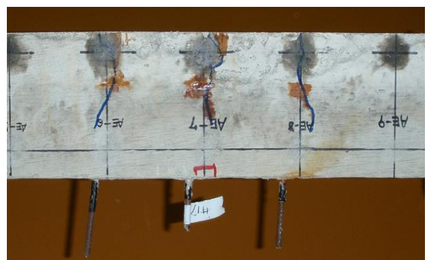
図-6 スターラップの腐食によって発生したひび割れ
