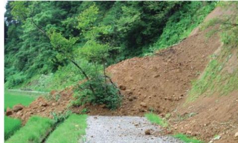
写真 1 斜面崩壊の事例 (新潟県中越沖地震)
