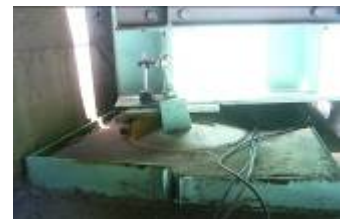
写真-3 変状写真
