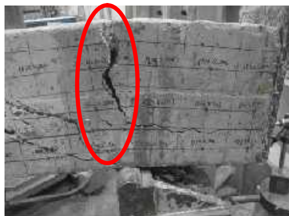
写真-1 定着部上縁ひび割れ
