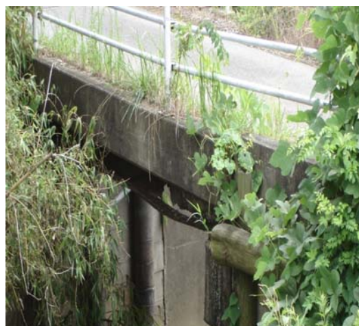
図 - 4 主桁の腐食が著しい橋梁
