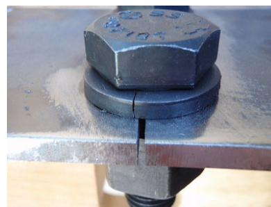
写真-4 ワッシャーに生じたき裂
