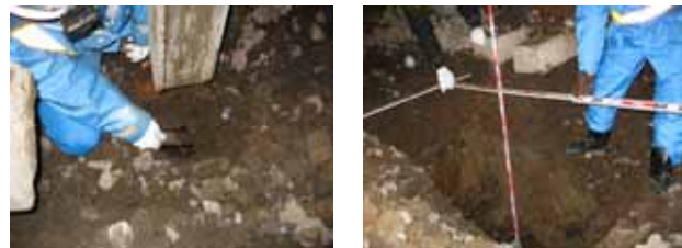
写真-2 掘削による空洞確認
