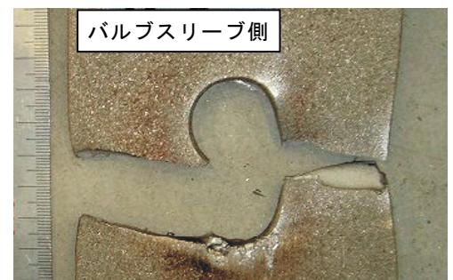
写真-2 破断後の母材
