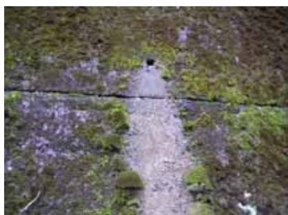
写真-1 水抜き孔からの土砂流出
