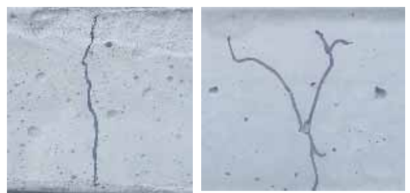
図6 中央部のひび割れ状況 (右 E3 左 E5)
