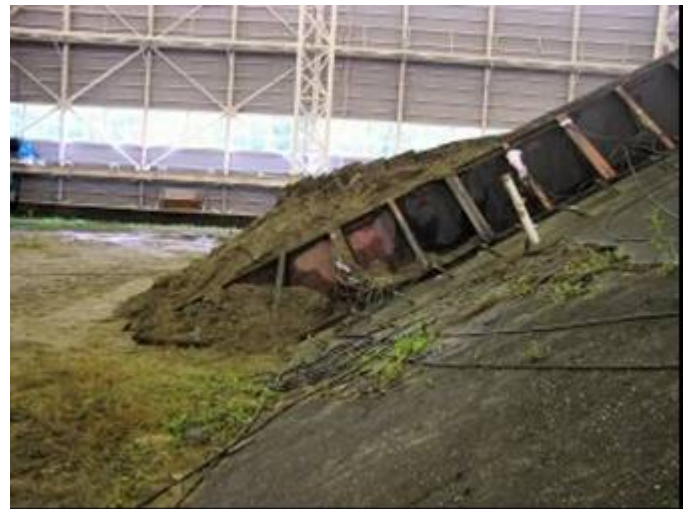
図-5 2007 年度の崩壊後の写真
