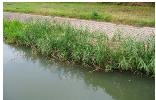
図-3 洲 (堰から上流 150m 付近)
