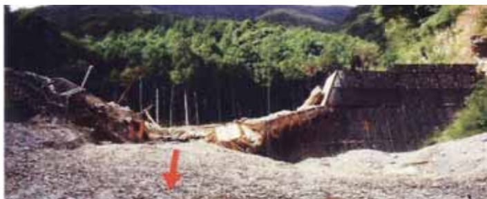
写真-1 破壊事例
