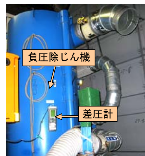
写真-4 差圧計・負圧除じん機
