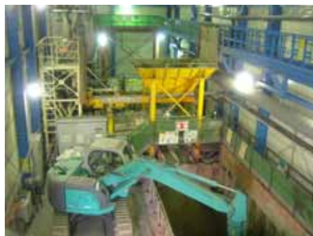
写真 - 2 土砂改質設備
