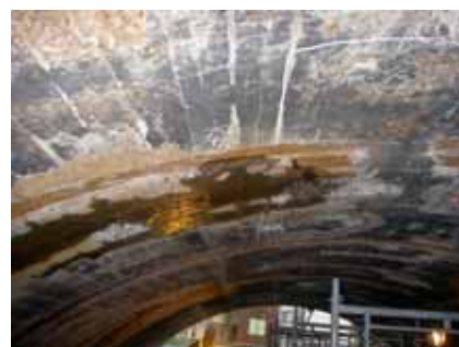
写真5 補強前状況(上床版)
