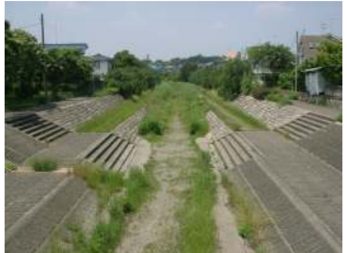
写真-1 水涸れの状況 (2005/6/5)
