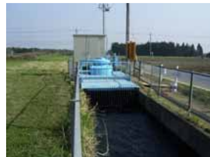
写真 - 1 実証試験設備
