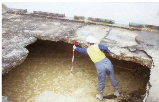
写真 1 港湾における空洞化の被害
