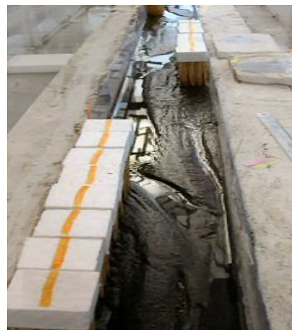
写真-1 停水後の様子
