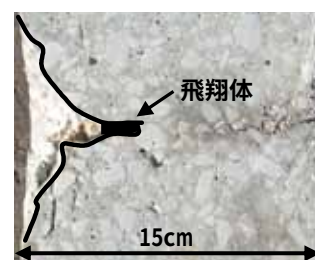
写真-3 表面破壊の状況
