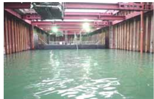
写真 - 1 躯体移動状況 1
