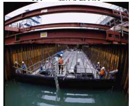
写真 - 2 躯体移動状況 2
