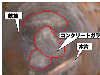
写真3 鋼管内支障物
