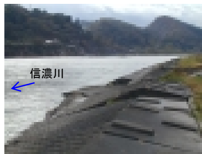
図-8 越の大橋付近の低水敷護岸の変状
