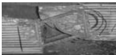
写真-2 打継ぎ目有りのループ継手の破壊形状
