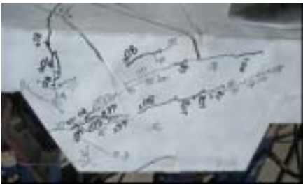
写真-2 定着部破壊状況 (U 字筋有り、60N-2)
