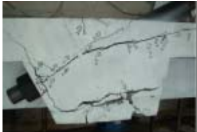
写真-3 定着部破壊状況 (U 字筋無し、60N-5)
