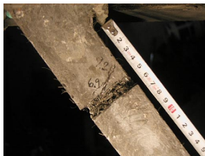
写真-1 トラスの破断
