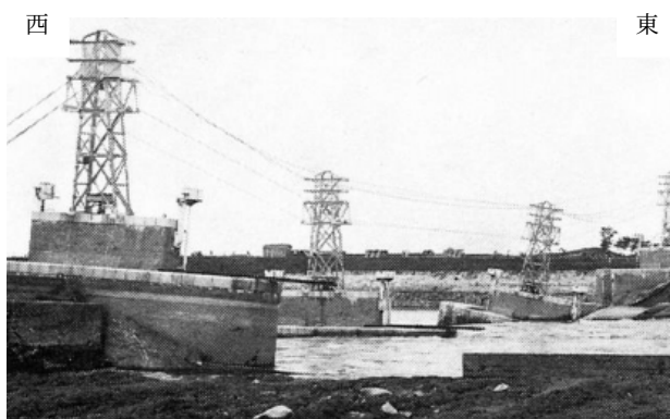
図 2 陥没した自在堰 3)
