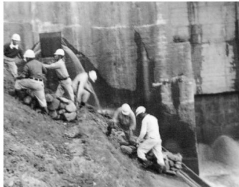
図4 洗堰右岸取付橋台及び護岸部漏水状況 3)
