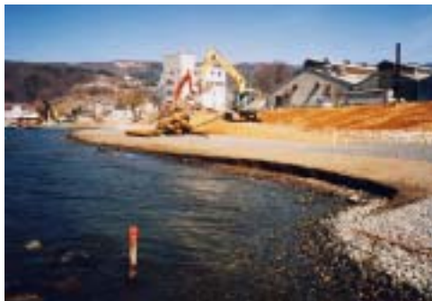
写真-1. 湖岸の浸食状況. 1997 年
