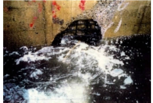
写真 - 1 被災写真
