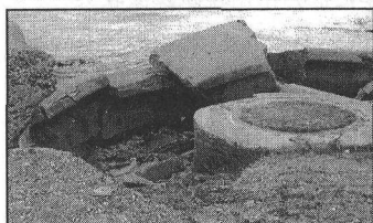
写真2 27cm カノン砲砲座部崩壊の様子
