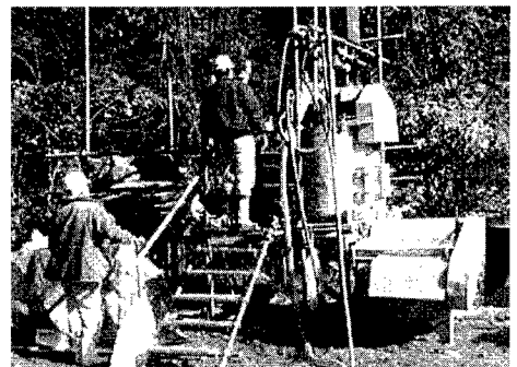
写真-1 坑外プラント
