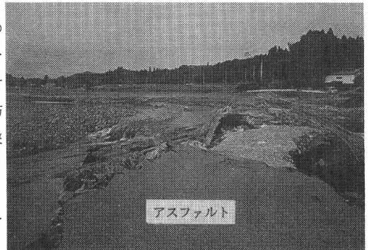
写真-1 破壊された道路（上流を見る） (道路を乗り越えた氾濫流が下流側に深堀をつくり、道路を背面から侵食した。道路の前面に広がっていた田は、河道の一部となっている) (9月2日14時撮影)
