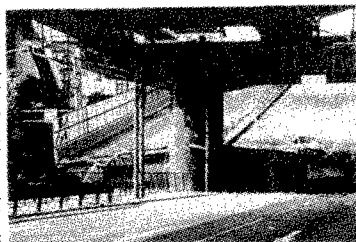
写真1 橋桁 S3 および S4 の落橋
