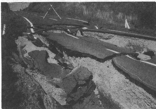
写真-2 切盛り境の被害例 (中標津町)
