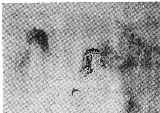
写真-1 外壁の可視状況（剝離部分）
