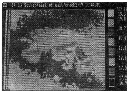
写真-2 外壁の表面温度分布画像（剝離部分）
