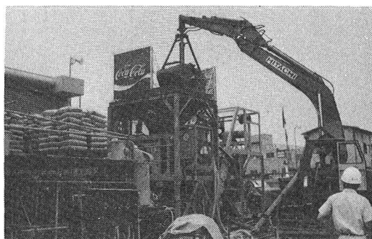
写真-1 プラント稼動状況
