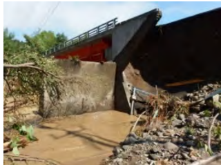
図-2 豪雨災害により橋台背面土が流出した事例
