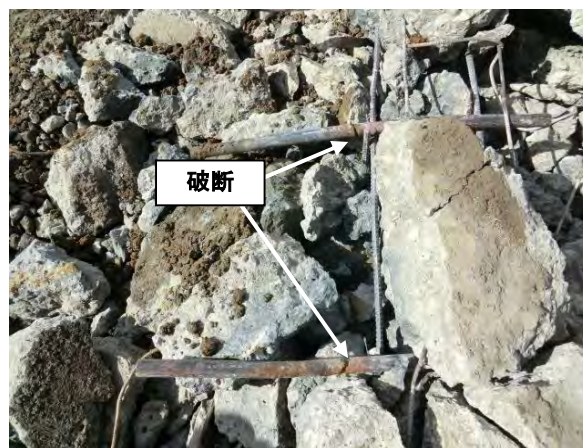
写真-4 ダウエルバーの腐食
