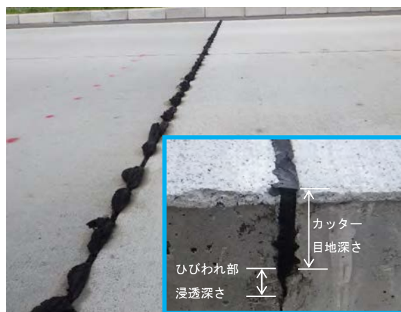
写真-7 注入目地材のはみ出し
