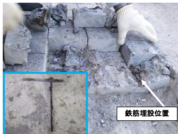
写真-6 剥がれ部の開削状況（鉄筋位置に錆あり）
