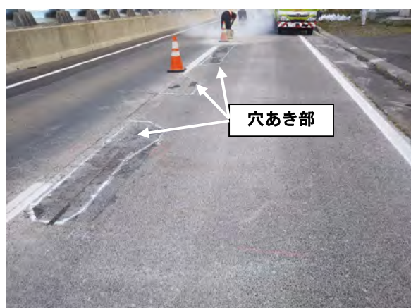
写真-5 コンクリート舗装版表面の剥がれ
