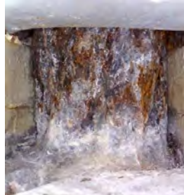
写-3 口元部の腐食状況
