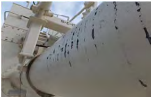
写-4 ケーブル端に生じた塗膜ワレ
