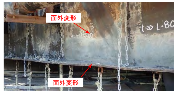
写真-1 主桁腹板および下フランジ変形状況 (第3径間)
