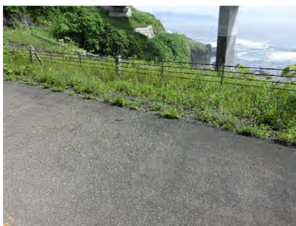
写真-3 廃道区間のケーブル型防護柵の状況
