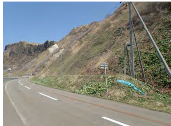
写真-1 落石防護土堤の一例
