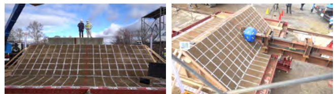
(g) 背面に水平方向のひび割れ発生
