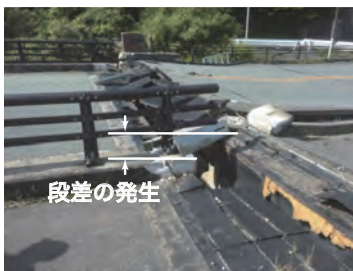
写真-1 地震による橋梁の被災事例 1)
