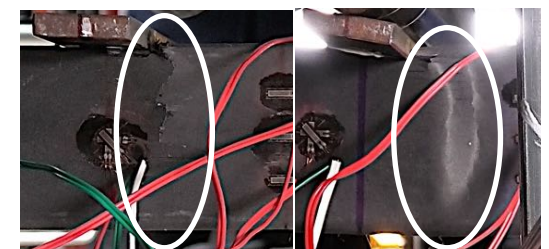
(c)左: SH9-A のひび割れ、右: SH9-B の隆起
