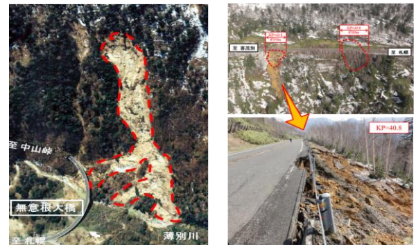
写真-1 国道 230 号中山峠の被災状況
