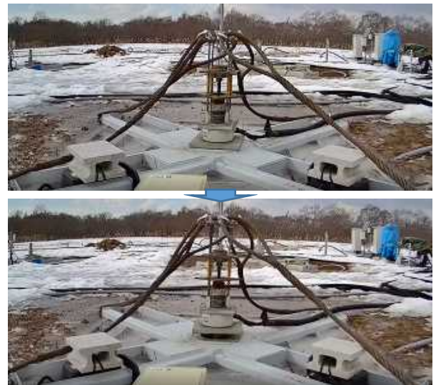
写真-2 凍上によるグラウンドアンカー破断の瞬間（GA-1）
