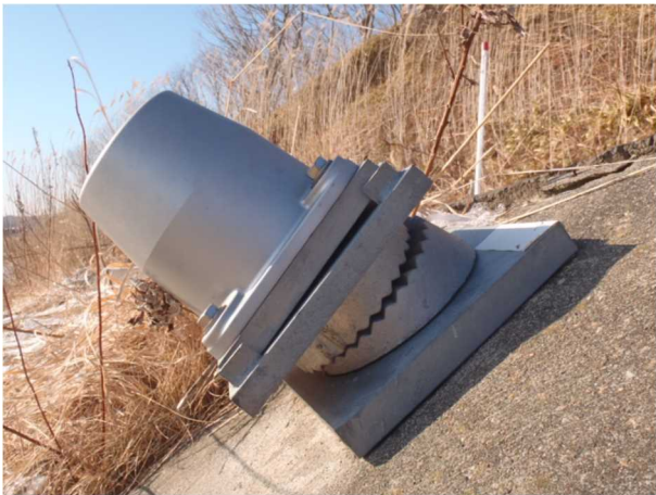
写真-1 凍上によるグラウンドアンカー（GA）頭部の損傷
