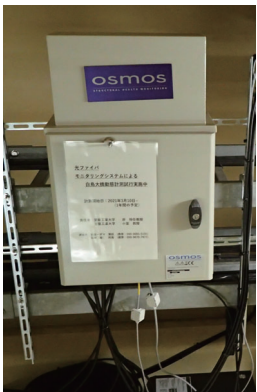
図-2 モニタリングステーション部
